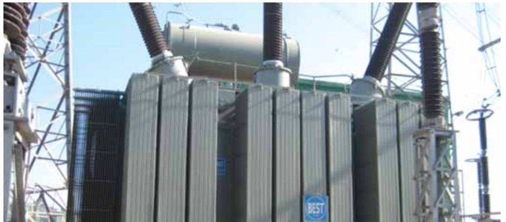
• 230MVA, 380kV - İÇTAŞ
