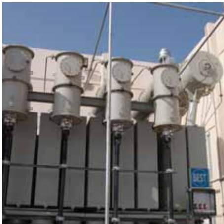
• 73MVA, 110kV Jeddah - ICY5
