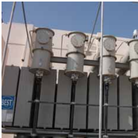
• 73MVA, 110kV Jeddah - ICY5
