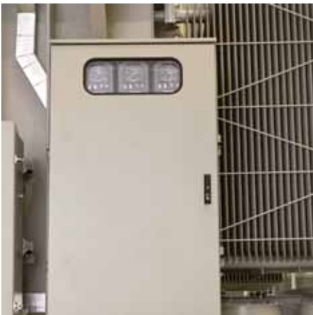
• Fan control panel
